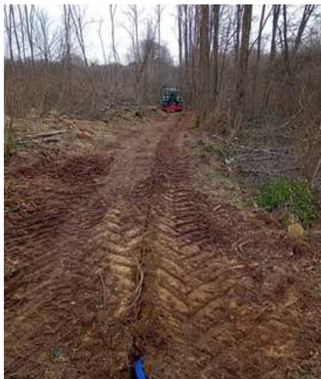
Chantier à Estivaux (Montcoulon) suite à fuite d'eau importante.
