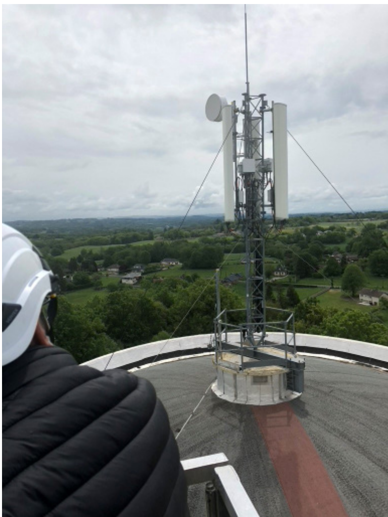
Les antennes téléphoniques au sommet du château d'eau
